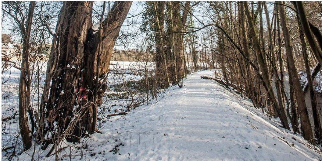
Abbildung 11: Bewachsene Deiche am Ufer der Dhünn, die die Wirkung infrage stellen lassen
